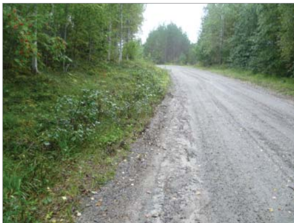
Museotien oikaistulla tieosuudella ovat valumavedet kuljettaneet hiekkaa tien reunalle ja ojaan ja heikentäneet tien kuivatuksen toimivuutta. Myös muutamat rummut notkelmassa ovat huonokuntoisia. Kuva Laura Soosalu.
