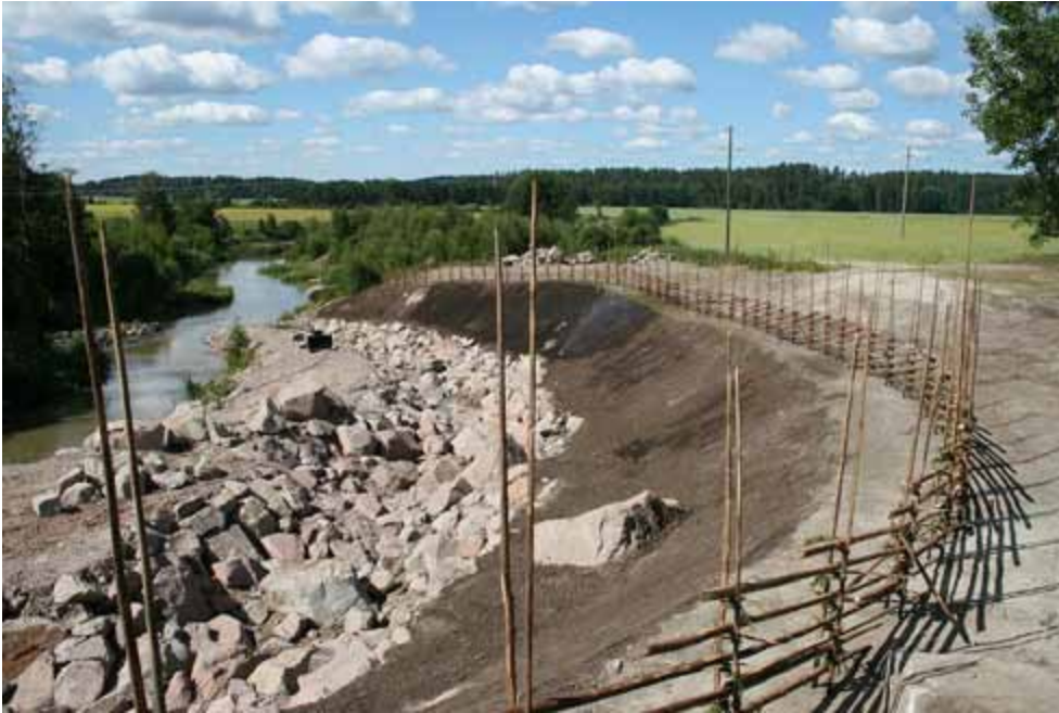
Kuva 11. Valmista riukuaitaa kalatien luiskan reunalla 29.7.2008. Luiska on verhoiltu mullalla ja kylvety nurmelle. Luiskaa kastellaan, jotta nurmi lähtisi hyvin kasvuun.
