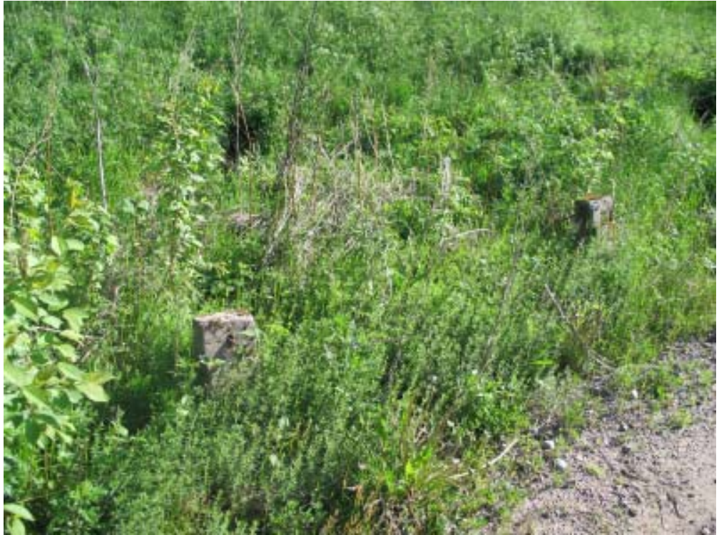
Kunnostusta vaativia sillankaiteita on muun muassa Lustojan kohdalla.
