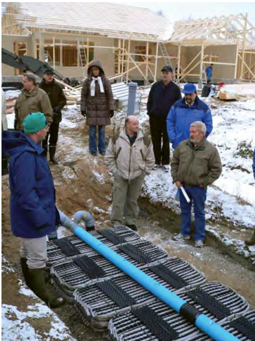
Figur 48: Flera fastighetsägare kan tillsammans undersöka möjligheten att installera ett gemensamt reningsverk. Foto: Anna Bonde
