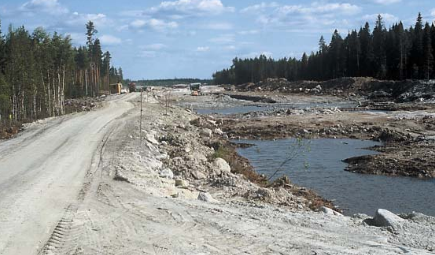
Kyrkösjärven kanavia kaivettiin vuonna 1978, kun Kyrönjoen vesistötöiden rahoitus oli huipussaan ja Seinäjoen kylkeen tuleva tekojärvi oli koko vesihallinnon suurin hanke.
