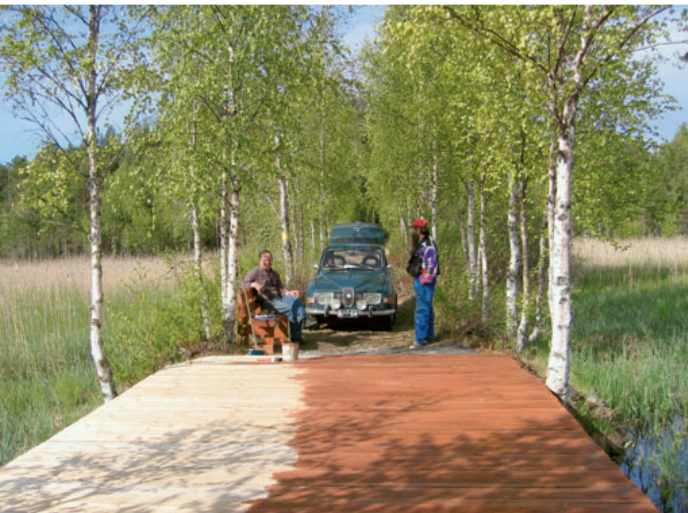
Pohjalammen luontopolulle rakennettiin silta ja penkki. Juha Salmela ja Matti Turpeinen maalaustyössä.
