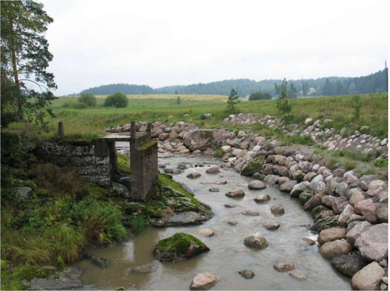
Kuva 35. Sammalkoskelle rakennettiin Villikkalanjärven joet -projektissa pohjapato vuonna 2005. Pohjapadolla nostettiin alivirtaamien vedenkorkeuksia n. 0,5 m ja keskivedenkorkeuksia n. 0,2 m. Laajimmillaan vaikutusalue on 3 km ylävirtaan. Kuva: Hanna Eskola.
