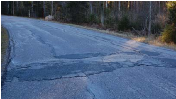
Pahimpia halkeamia tiessä on paikattu. LS
