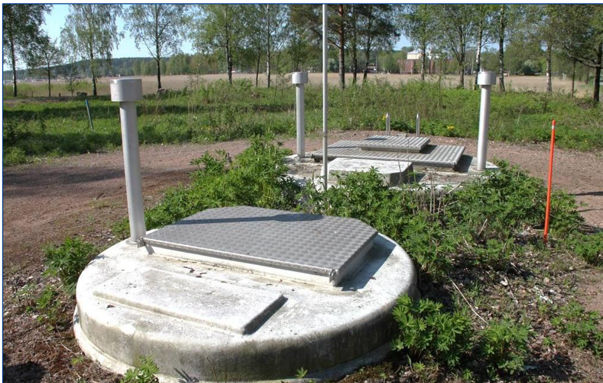
Bild 7.3.2-1. Pumpstationen för avloppsvatten vid korsningen Mannerheimgatan och Skärgårdsvägen (Foto: FCG Suunnittelu ja tekniikka Oy, av den 23.5.2014).
