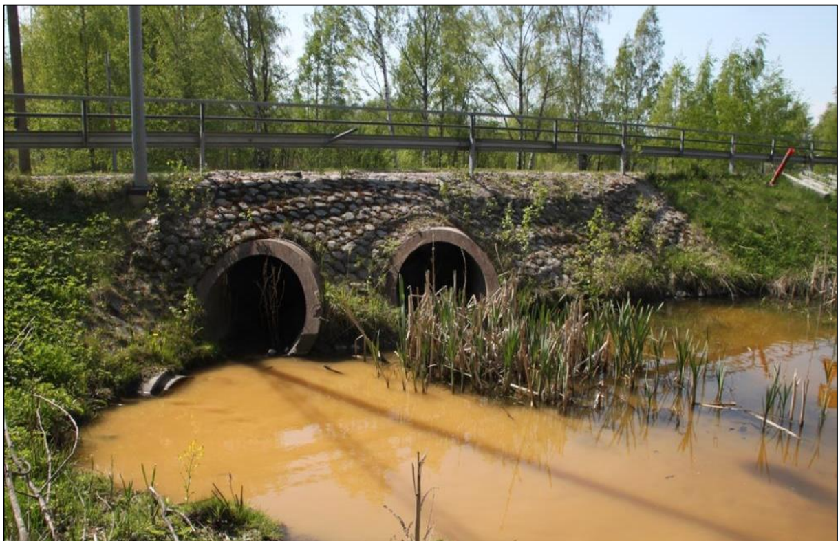
Bild 10.4.3-1. Stängning av vägtrumman vid Otnäsvägen (på kartan vid en översvämning med ett återkomstintervall på 1/100a). På den nedersta bilden visas den sida av vägtrumman som går mot havet.
