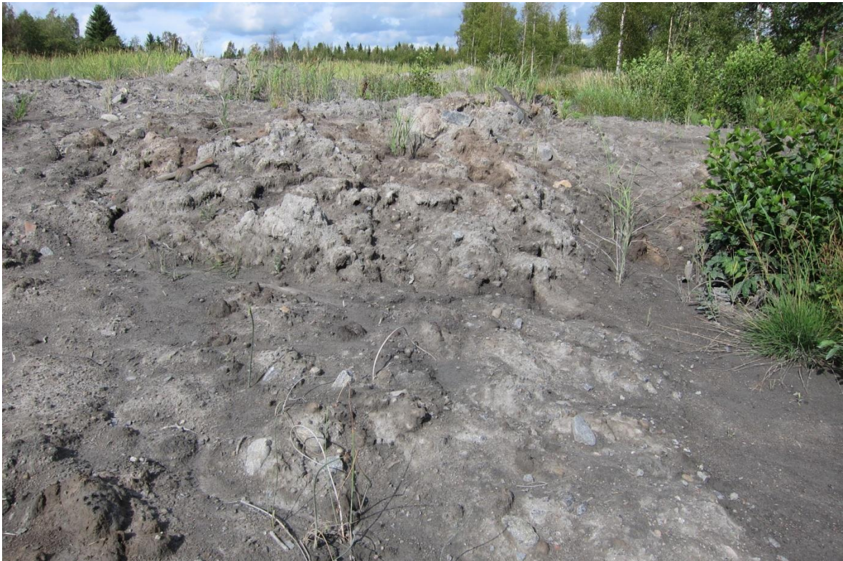
Bild 28. Erosion orsakad av regnvatten på den växtfria delen av deponeringsområdet 8 sommaren 2014.
