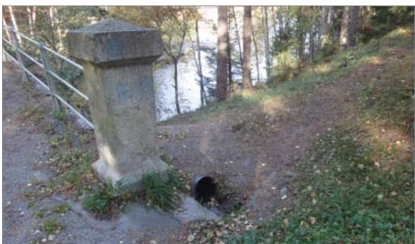
Sillalta ja kevyen liikenteen väylältä valuvia sadevesiä johdetaan sadevesiputkilla. Kuva Martti Piltz
