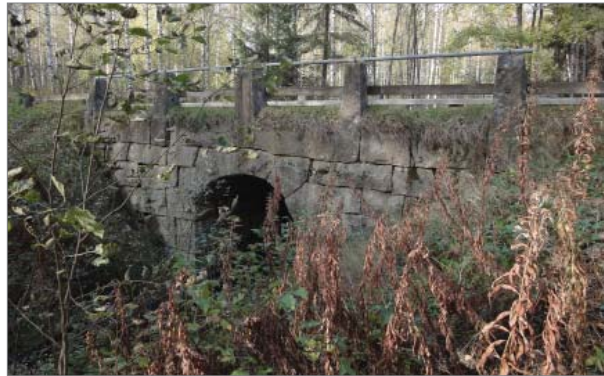
Paarlamin silta, joka on rakennettu v. 1901. Sillan alusrakenne ja päällysrakenne on perusparannettu vuonna 1990. Sillalle on tehty yleistarkastus vuonna 2011, jolloin sillan yleiskunto ja päällysrakenne todettiin huonoiksi. Kuva Martti Piltz
