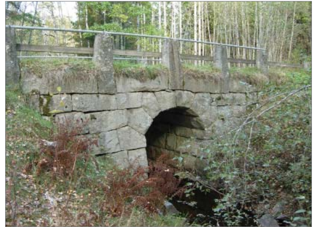
Seppälän silta, joka on kunnostettu v. 1974 sillan kaidepilarissa olevan kyltin mukaan. Alkuperäinen silta on rakennettu v. 1904. Sillalle on tehty yleistarkastus v. 2010, jolloin sen yleiskunto ja päällysrakenne todettiin välttäviksi. Kuva Laura Soosalu.
