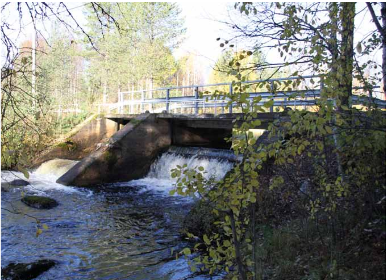
Kuva 13. Puhosjärven uittopato ja paikallisten silta, joiden yhteyteen on tehty pikkukalojen nousueste.
