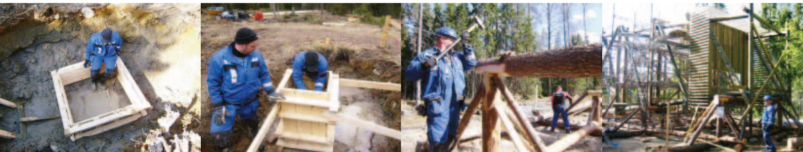
Näköalatornin rakentaminen vaati luovuutta työmenetelmien suunnittelussa. Torni rakennettiin vaakatasossa ja nostettiin pystyyn autonosturilla.
