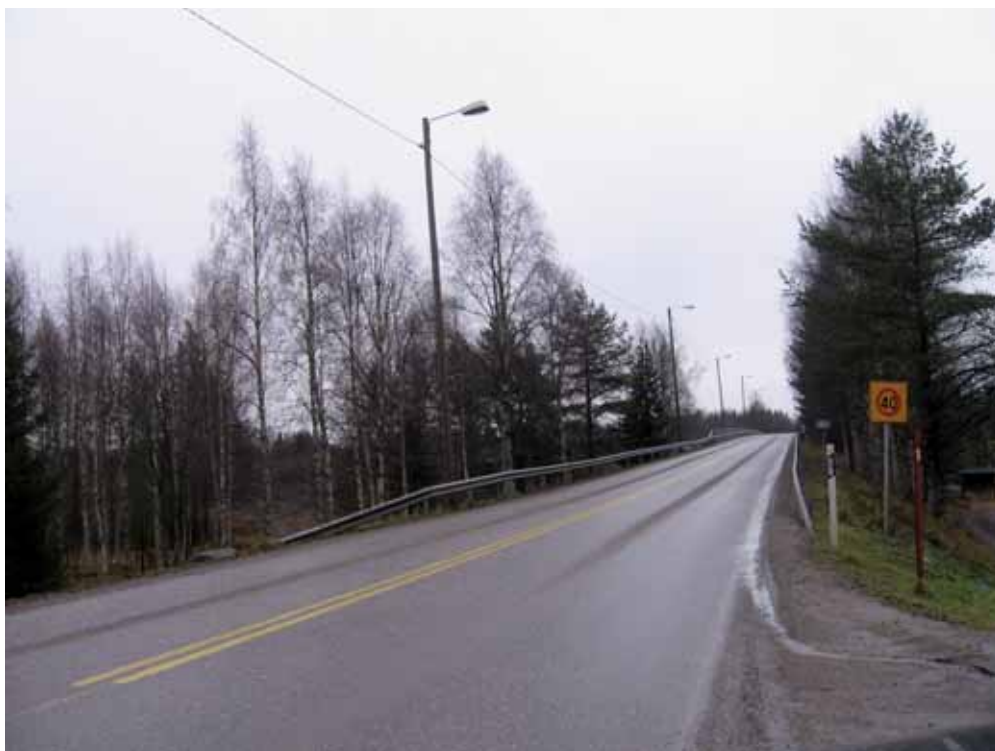
Kuva 23. Kiimingintien lijoen ylittävä silta on kapea eikä tiellä ole kevyen liikenteen väylää.
