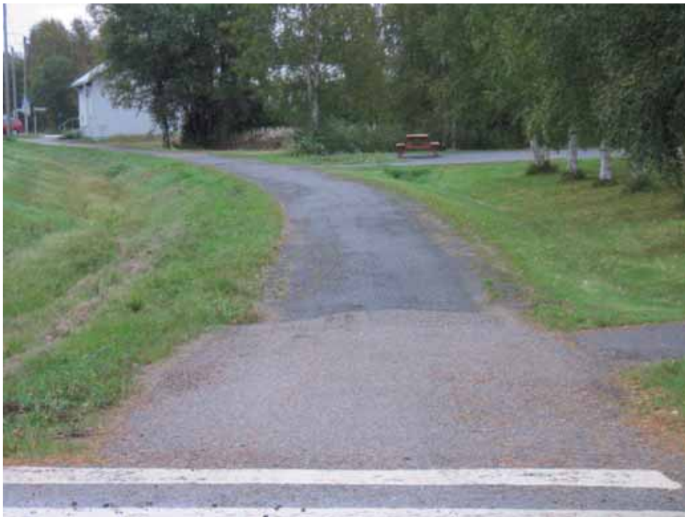
Kuva 25. Karjalantien varressa olevalla kevyen liikenteen väylällä on päällystys- ja routavaurioita.
