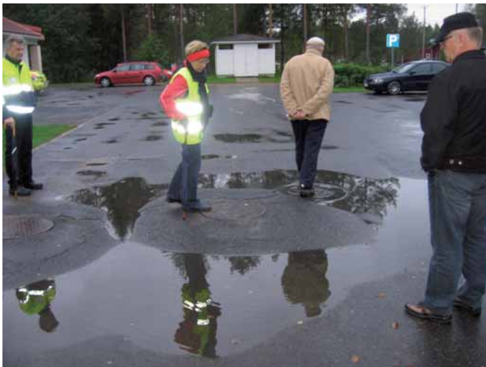
Kuva 27. Yli-lin terveyskeskuksen piha-alueella on painumia.
