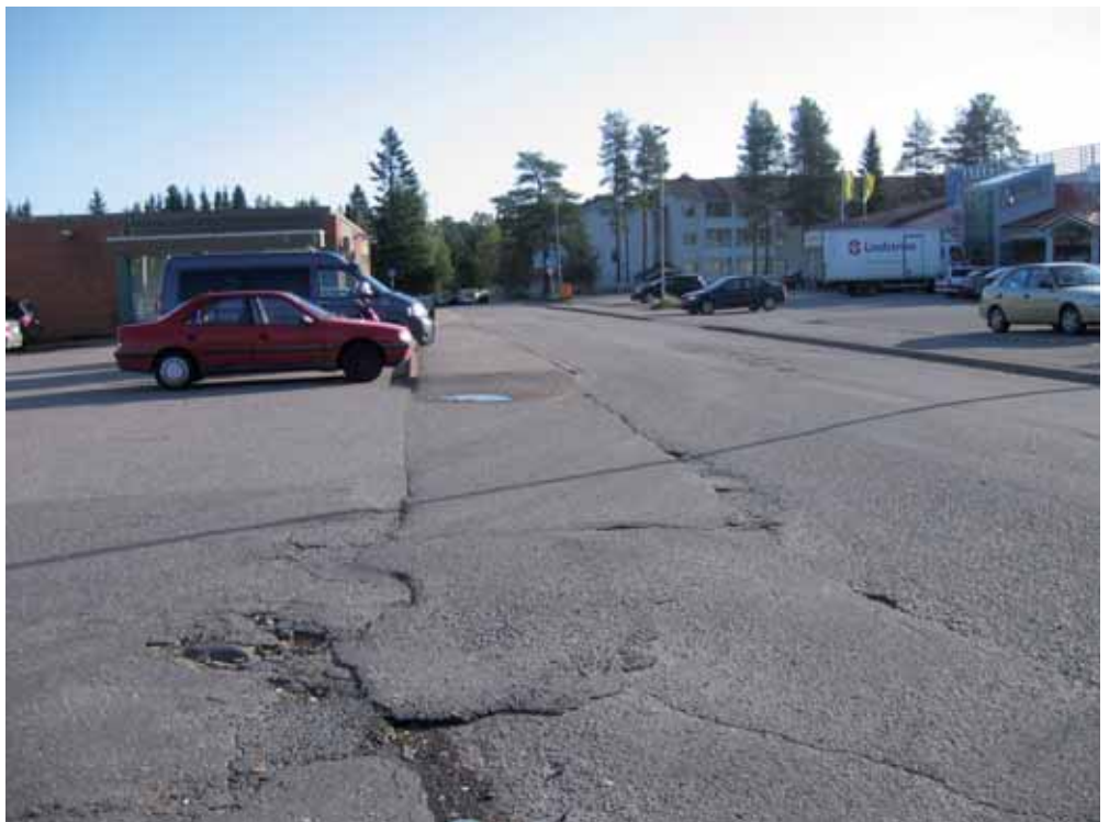
Kuva 31. Haukiputaan Väliellä on selkeä epäjatkuvuuskohta; kevyen liikenteen väylä loppuu laajalle piha-alueelle, joka on epätasainen ja turvaton kevyelle liikenteelle. Ajoneuvot kulkevat samassa tilassa.
