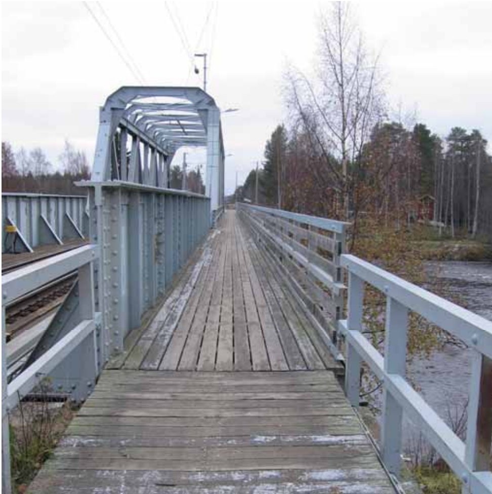
Kuva 29. Kiiminkijoen ylittävällä rautatiesillalla oleva kevyen liikenteen väylä koetaan vaaralliseksi mm. sillan kaiteista johtuen.
