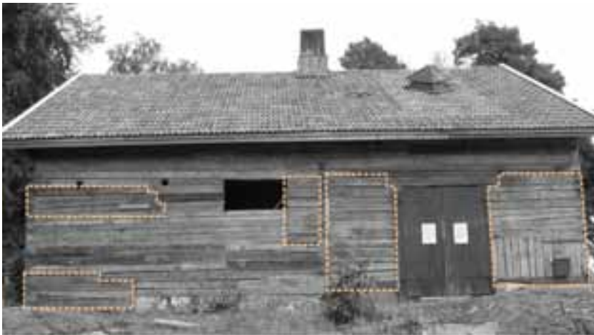
Pahasti lahovaurioitunut seinä jouduttiin uusimaan lähes kokonaan vanhaa hirttä käyttäen. Rajatut alueet alkuperäisiä.
