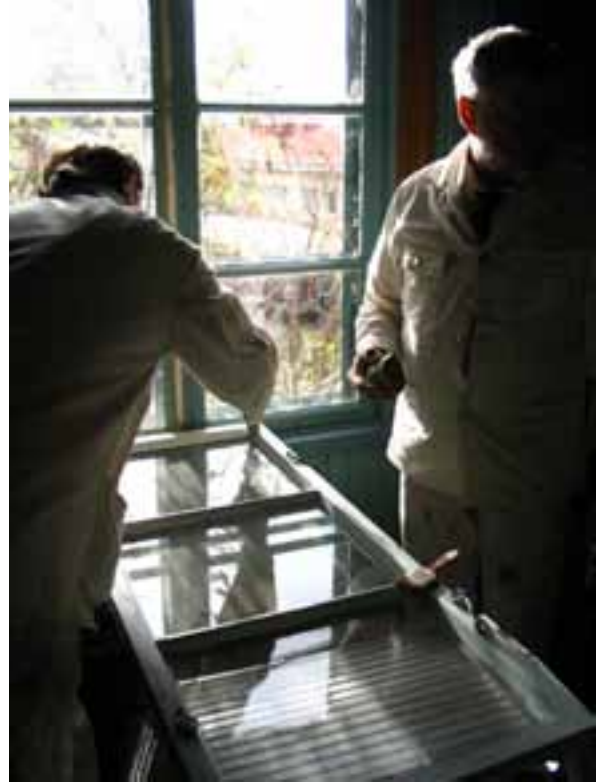
Curation järjestämällä kurssilla korjataan leivintuvan ikkunoita. Sivun kuvat: Curatio - Turunmaan korjausrakentamisyhdistys ry.
