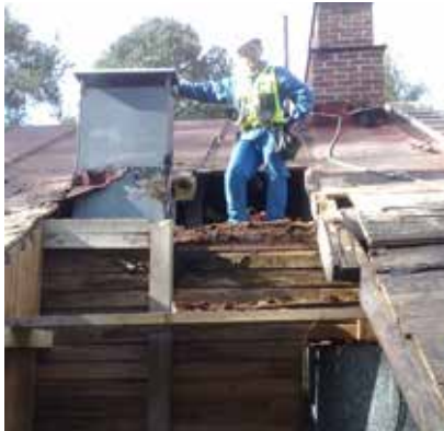
Lahovaurioita seinän yläosassa ja kattorakenteissa.
