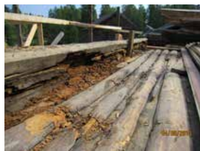
Lahovauriot yläpohjan kohdalla ulkoseinässä.
