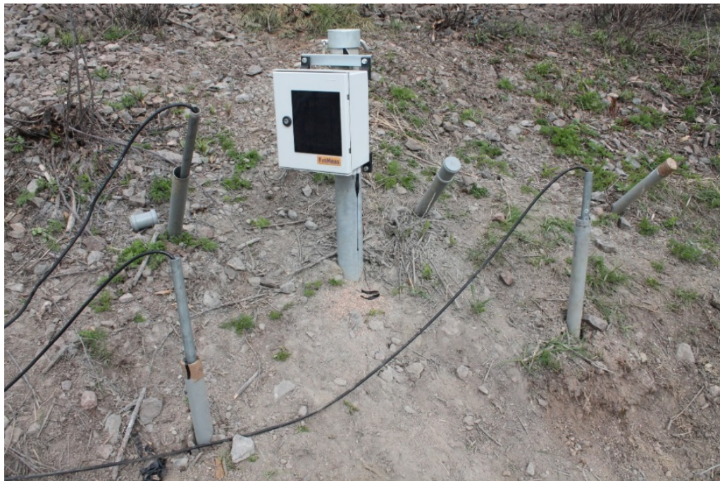
Kuva 16. FinMeas Oy:n asentama inklinometri sekä kolme asennettua huokosvedenpaineanturia kohteessa km 233+900.
