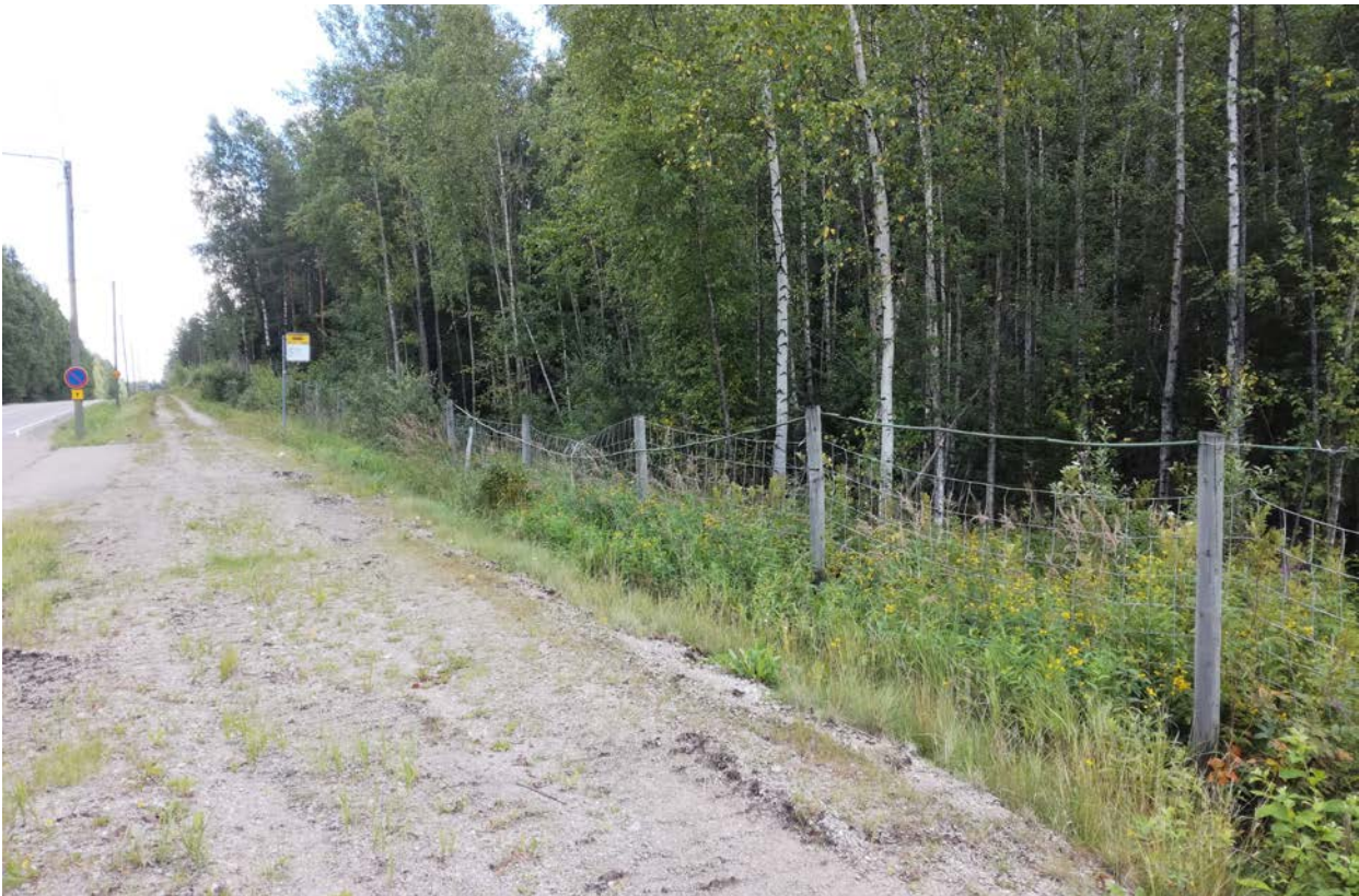
Kuva 6. Korjaustarpeessa oleva riista-aita.
