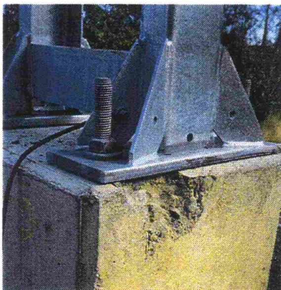
Kuva 2.8. Perustuksen yläosan murtuminen koekuormituksen aikana.
