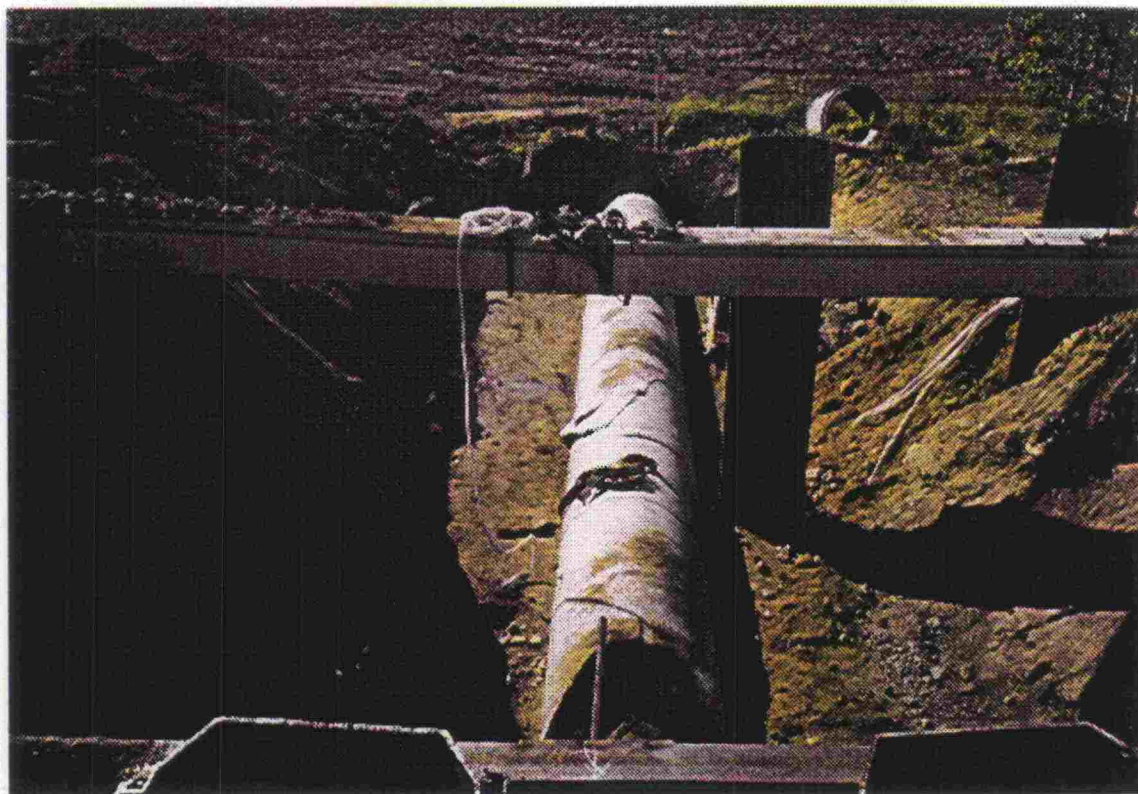
Kuva 2.4:6 Rummun puolivälin tasolle (Kv -2,5 m) asennetut täyttösoralla peitetyt mittausinstrumentit.
