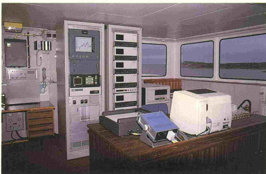
Näkymä kaikuharausalus Airiston mittaustoimintojen ohjauskeskuksesta. Etualalla kaikuharan hoitajan työpöytä tietokonepäätteinen ja piirtureineen. Taustalla vasemmalta paikannuslaitteisto, tietokone, 39 kanavan luotainyksikkö, magneettinauha-asema ja levy-yksikkö.
