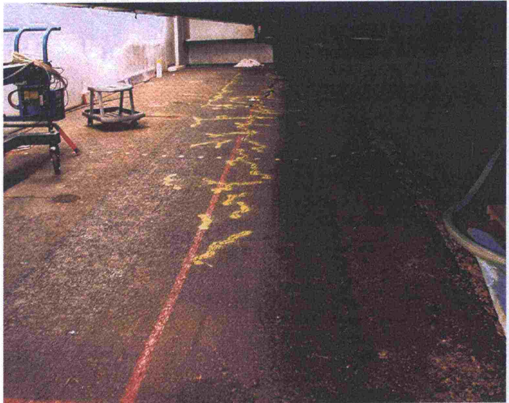
Kuva 1. Koko rakenteen vauriot. Oikealla luiska.
