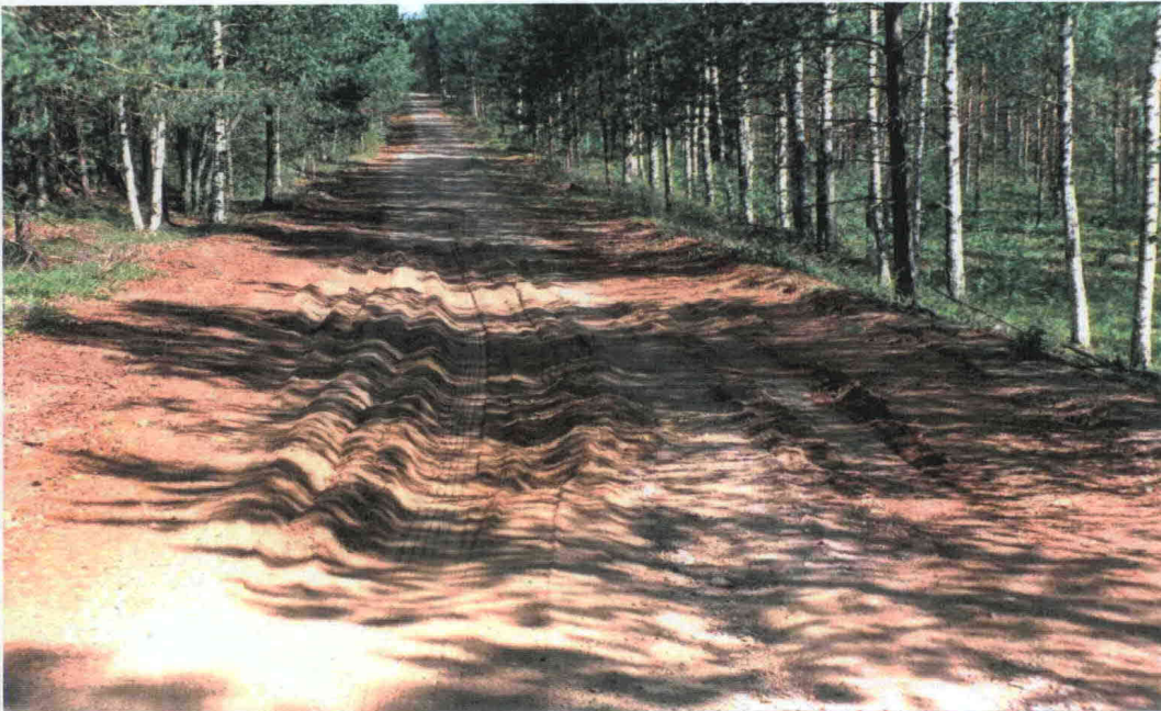
Kuva 2. Varareitiksi valitun tien ominaisuuksien tulee vastata päätien liikenteen tarpeita. Tässä tie ei ole kestänyt päätieltä siirrettyä raskasta liikennettä. Kuva on ennen varareittien suunnittelua olleesta varareitin käyttötapa- uksesta valtatieltä 6 Utissa.
