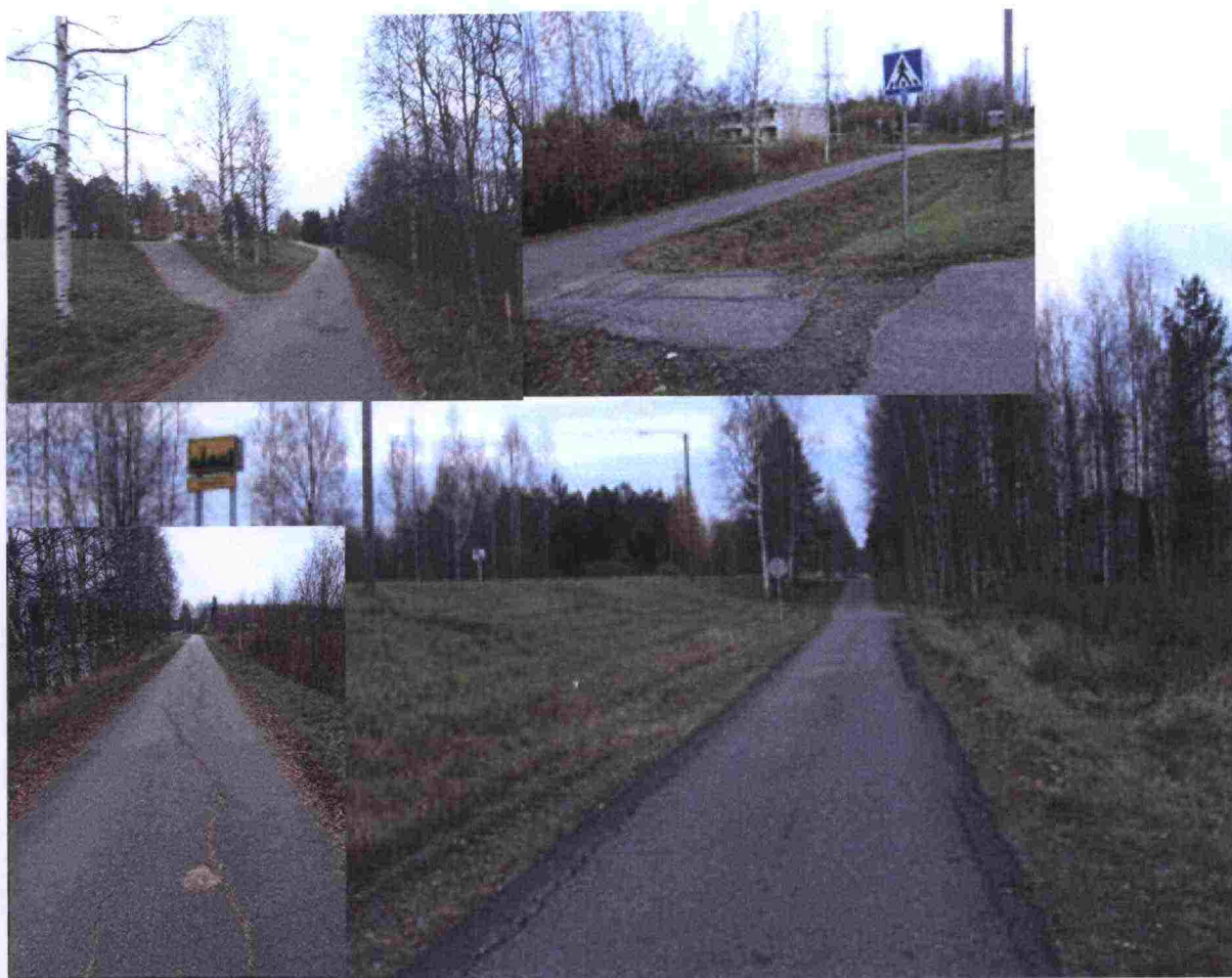
Kuva 10. Päällysteen rikkonaista reuna matkalla Reijolaan ja pysäkkiyhteyden päällystevaurio. Kevyen liikenteen väylä kulkee ajoneuvoliikenteen väylää alempana, jolloin tonttiliittymän kohdalla nouseaan pienen kukulan päälle. Alavasemmalla pitkittäisvaurioita Kontiolahden Lamminrannassa.
