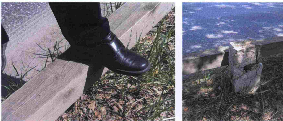
Kuva 3. Kaide on monin paikoin aivan liian matala ja betonisten pylväiden osalta huonossa kunnossa.
