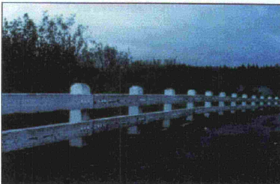
Kuva 18. Columbia River Highwayn uutta "terästaustaista" puukaidetta. Kaide on testattu nopeudella 80 km/h (7).
