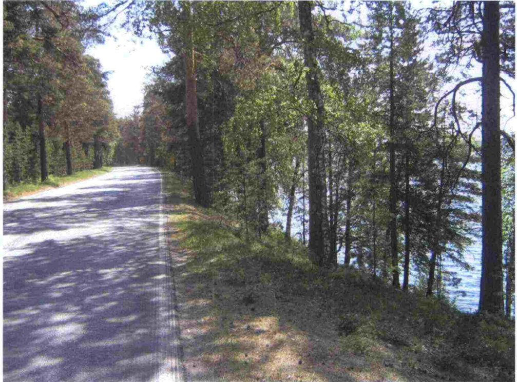
Kuva 4. Harjutiellä on useita kohtia, joissa suistumisturvallisuuden perusteella tulisi olla asianmukainen kaide.
