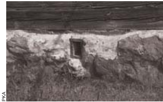
Alapohjan tuulettaminen on hoidettu avaamalla keväällä "kissanluukut". Orpola, Suorlahti.
