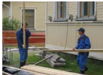
Yty-työntekijät purkivat vanhan katon ja laittoivat uuden aluslaudoituksen peltikattoa varten. Tiilikaton alta paljastui vanha pärekatto.
