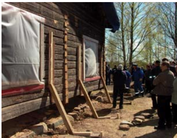
Mäntylän torppaa on nostettu ja huonokuntoiset alahirret on poistettu. Kengitykseen käytetään vanhoja hirsiiä.
