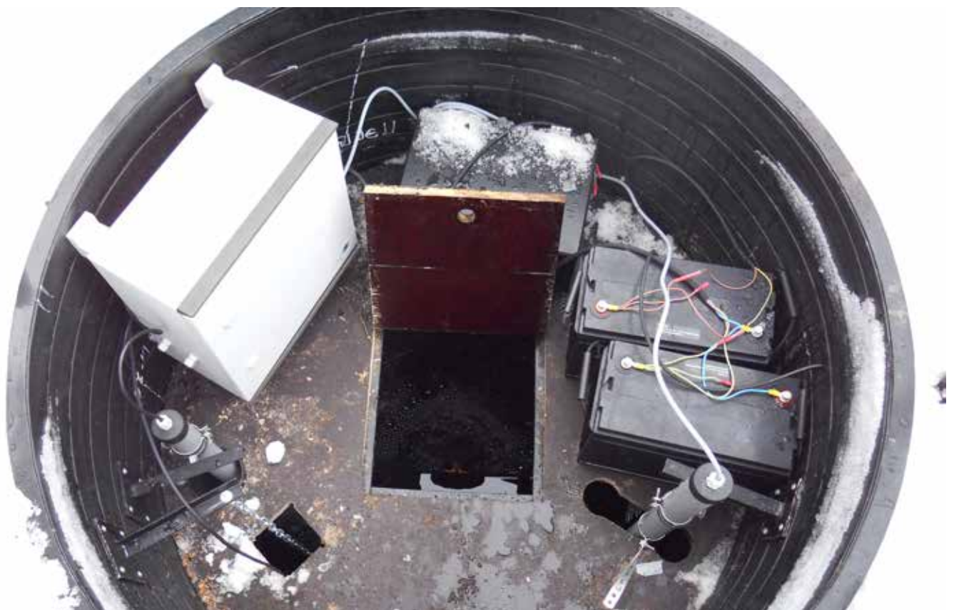
Kuva 3. Hyvin eristetyt mittakaivot toimivat ympärivuotisesti.
