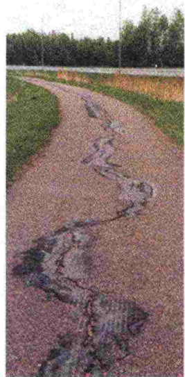
Huonokuntoinen jalankulku- ja pyörätie.
