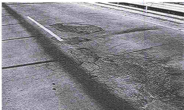
Kuva 12. Päällysteen purkautuma on korjattava välittömästi.
