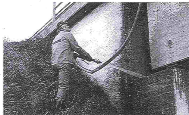
Kuva 23. Vesipesu on suositeltavin laakeritason puhdistustapa.
