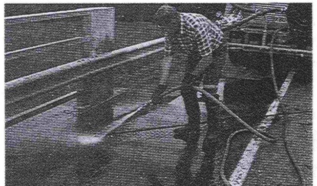
Kuva 20. Liikuntasaumalaitteisiin kerääntynyt hiekka ja muu irtonainen aine poistetaan joko harjaamalla tai vesipesulla.
