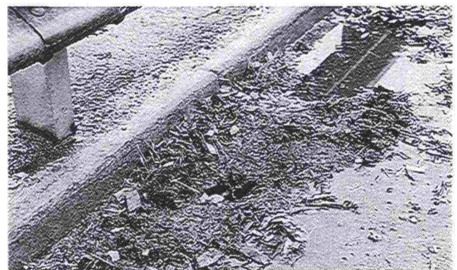
Kuva 10. Syöksytorven yläpää on täysin tukossa.
