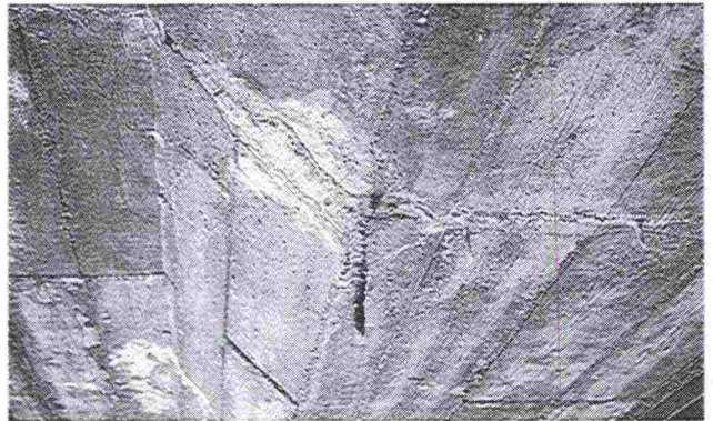
Kuva 3. Kalkkiläiskät ja -puikot kertovat vesivuodoista.
