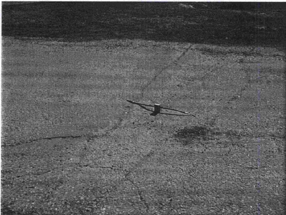
Kuva 24. Poikittainen painuma (lievä haitallinen epätasaisuus) ja poikkihalkeamia. Painuma on loiva, joten se ei aiheuta pyöräilijälle voimakasta tärähdystä, mutta on kuitenkin selvästi havaittavissa.
