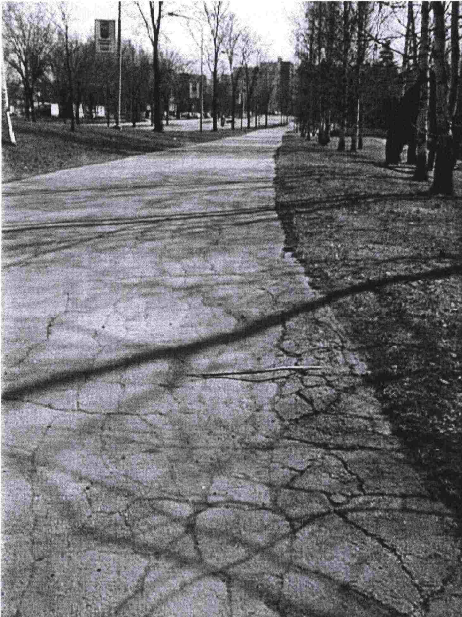
Kuva 17. Reunapainuma ja verkkohalkeamaa.
