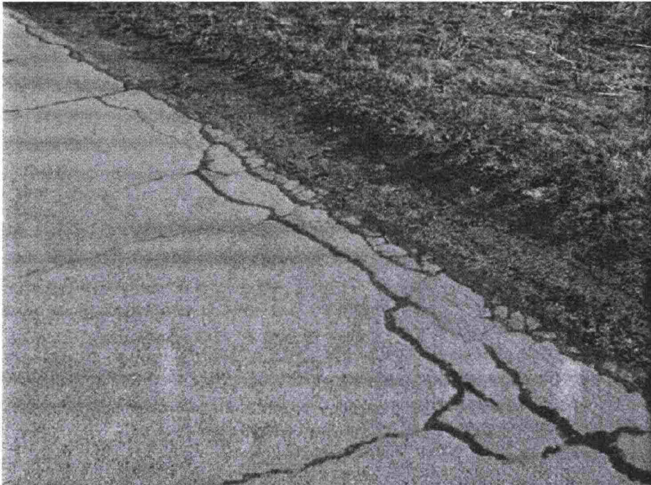
Kuva 14. Selvästi havaittavia reunamurtumia.
