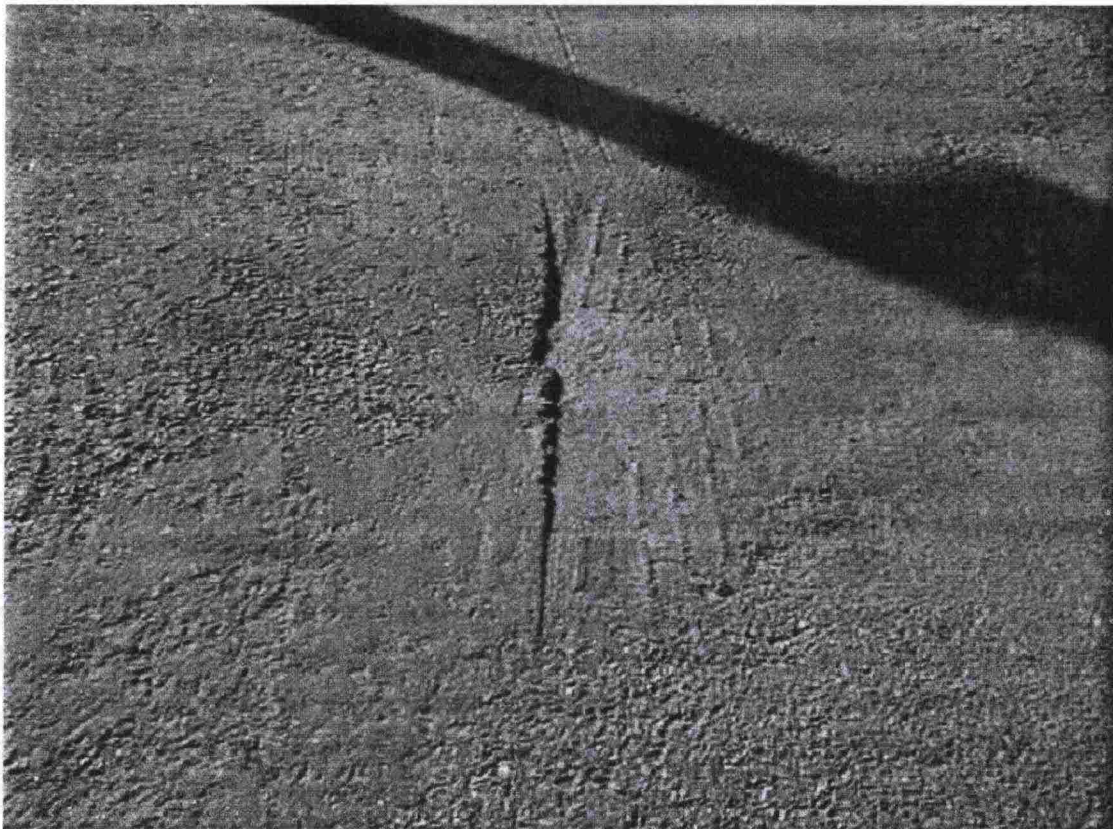
Kuva 27. Työkoneen aiheuttama pintavaurio.
