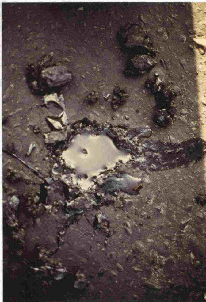
Kuva 4. Bitumiöljystä erkaantunutta ainesta veden pinnalla sideaineen pintaannouskohdassa. Ainesta on poikkeuksellisen runsaasti.
