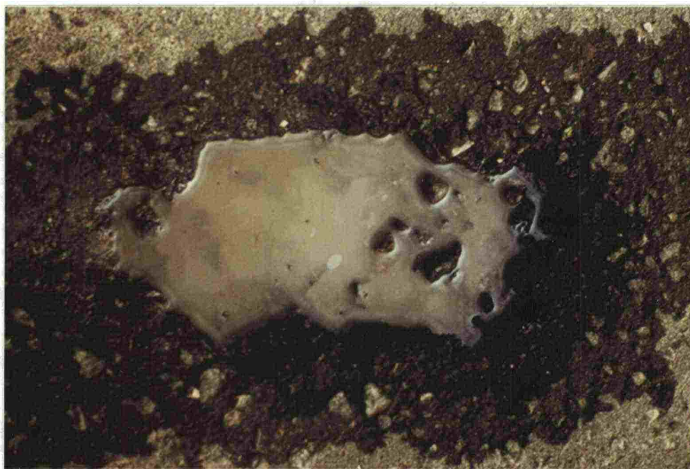
Kuva 3. Irtoava aines vauriokohdassa. Sen pintajännitys ja rajapintajännitys veteen nähden ovat suuria. Aines on vettä kevyempää.
