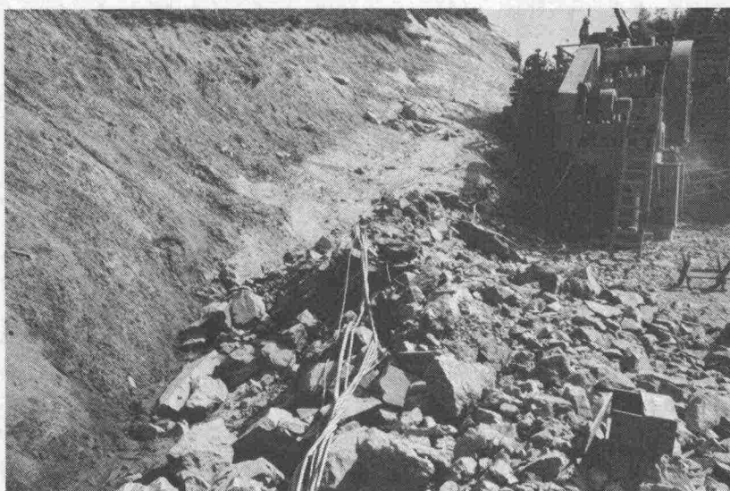
Hyvä ja huono esimerkki kaapeleiden sijoittamisesta.
