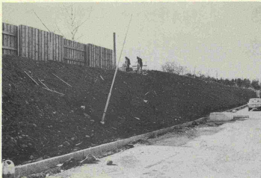
Rakenteilla oleva maavalli ja meluseinä. Maavallin korkeus n.5 metriä tasausviivasta ja seinämän korkeus n. 2.5 m
