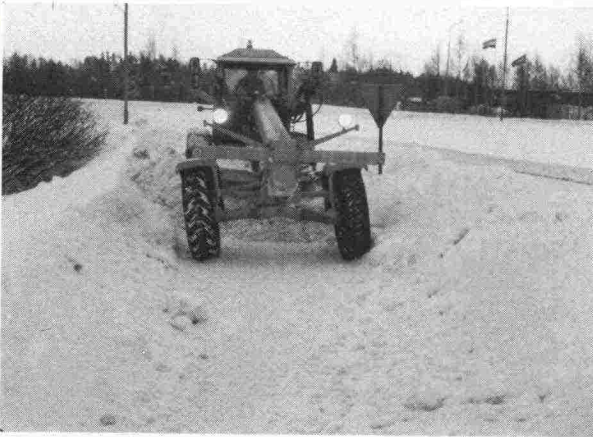
Kuva 4. Tiehöylää käytetään kevyen liikenteen väylien lumenpoistoon lähinnä vain silloin, kun samalla halutaan suorittaa pinnantasausta.
