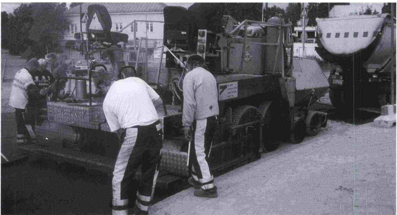
Tielaitoksen tiemerkinnyt, perinteinen kunnossapito sekä teiden ja katujen päällystäminen (asfaltointi) muodostavat kokonaispalvelun, jota tarjotaan myös kunta-asiakkaan käyttöön.
