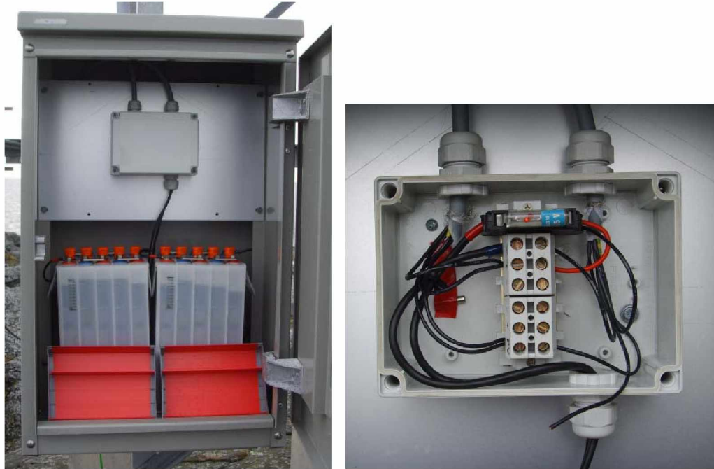
Kuva 2. Laitekaappi, kun lataussäädin on lyhdyssä.
