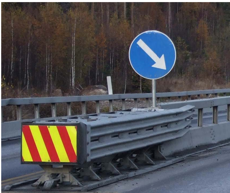
Kuva 14. Törmäysvaimennin työnaikaisen kaiteen päässä.
