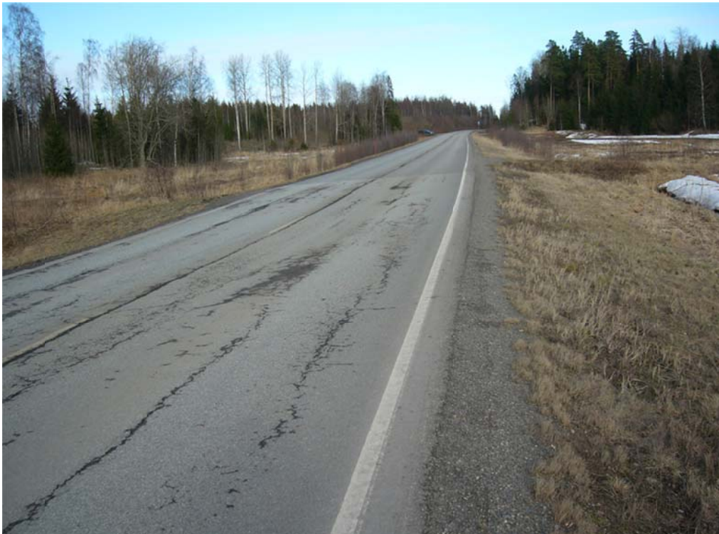
Kuva 7. Tie vaurioituu painuman kohdalla nopeammin. (Pertti Virtala).
