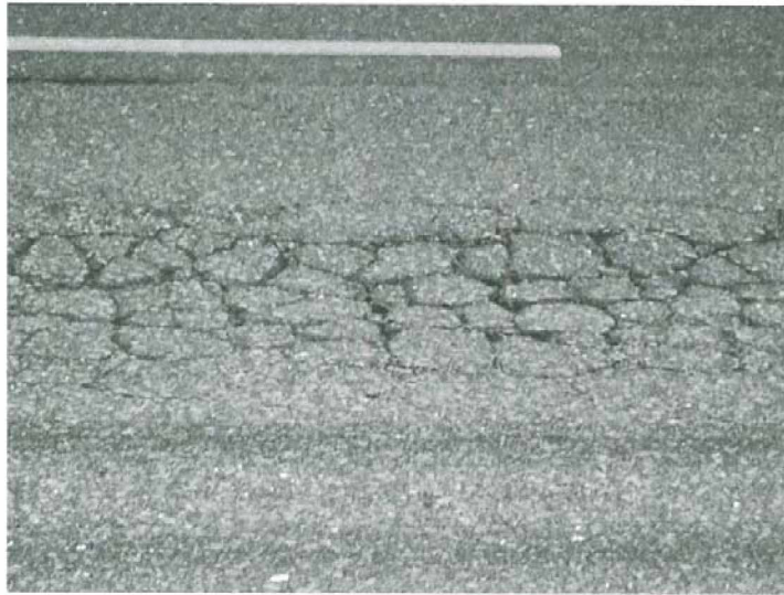
Kuva 22. Väsymishalkeamia asfalttipäällysteessä ajouran kohdalla. (Doré & Zubeck 2009, s. 66)
