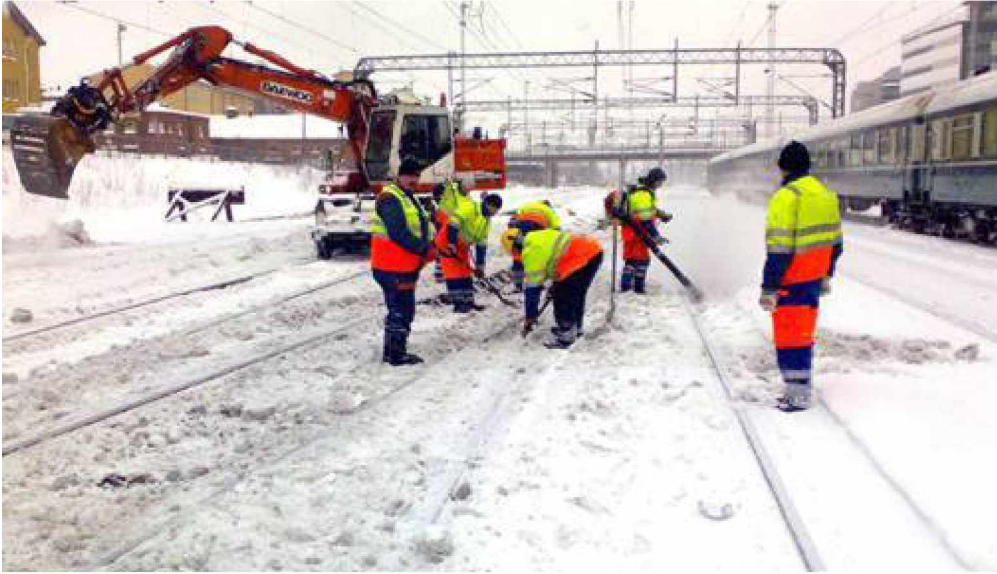
Kuva 17. Vaihteen puhdistusta lumesta Tampereen ratapihalla harjojen, lapioiden, suuritehoisen puhaltimen ja kaivinkoneen avulla.
