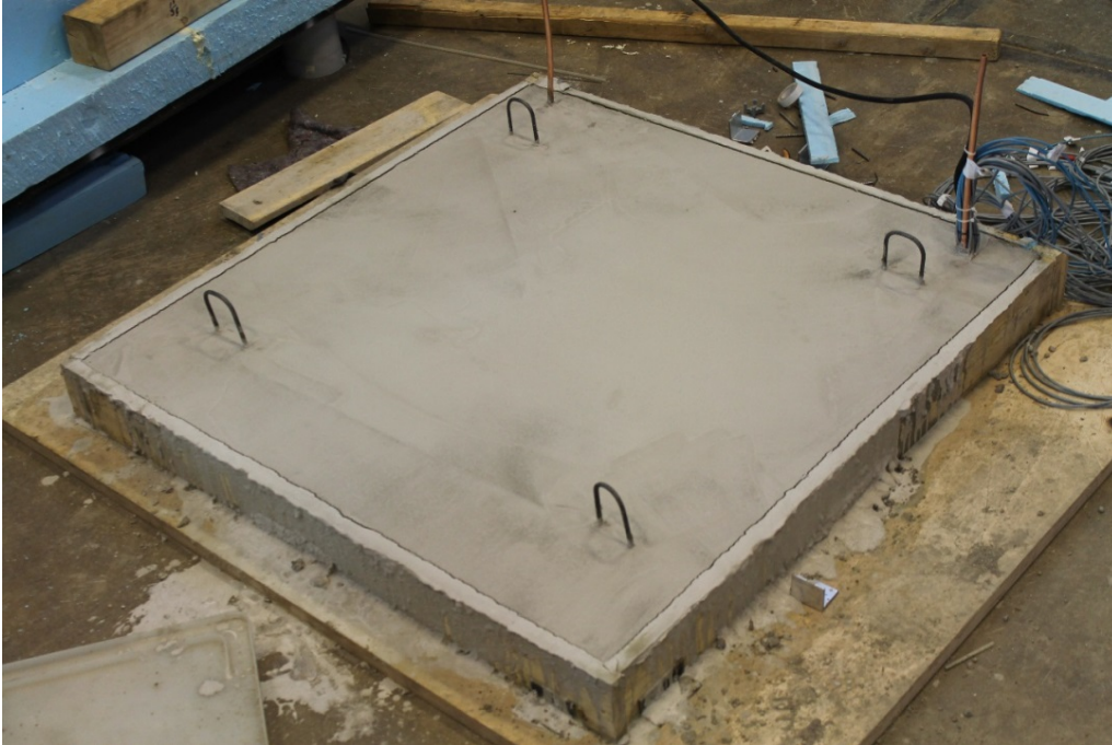
Kuva 4.14 Ylälaatta valun jälkeen. Laatan pintaan on asennettu nostokoukut, jotta painavaa laattaa voidaan siirtää siltanosturilla.
