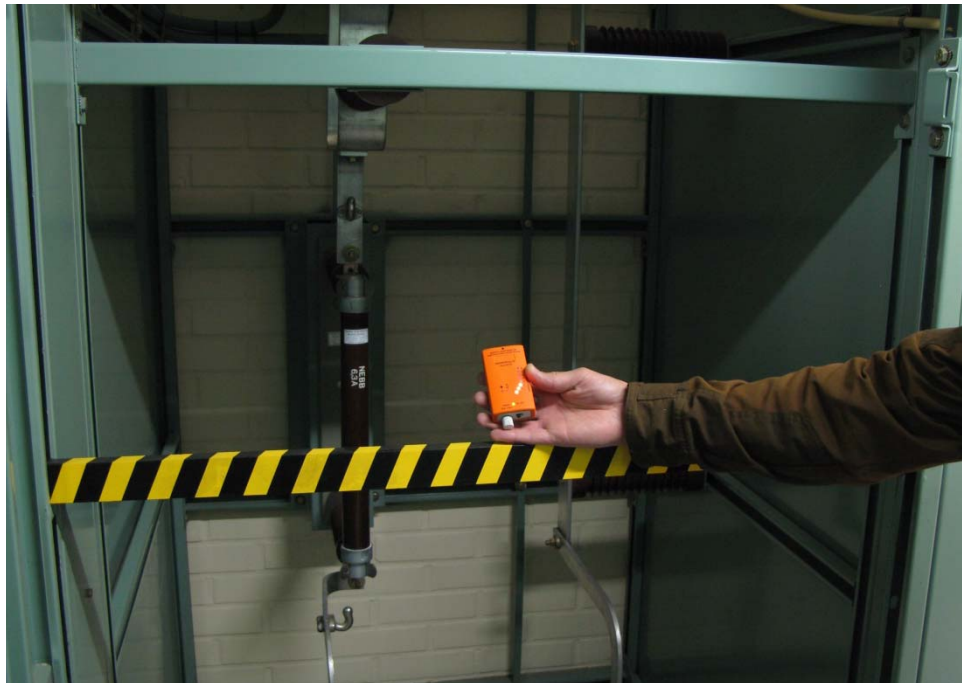
Kuva 29 JET-laitteen antama tulos kytkinasemalla
