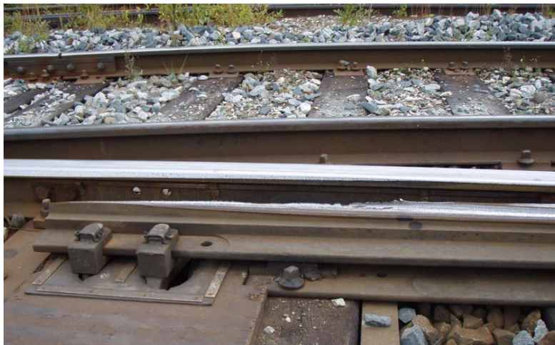
Kuva 2.13 Vaurioitunut vaihteenkieli Pieksämäellä 2010 (Kosonen 2011, s. 47).
