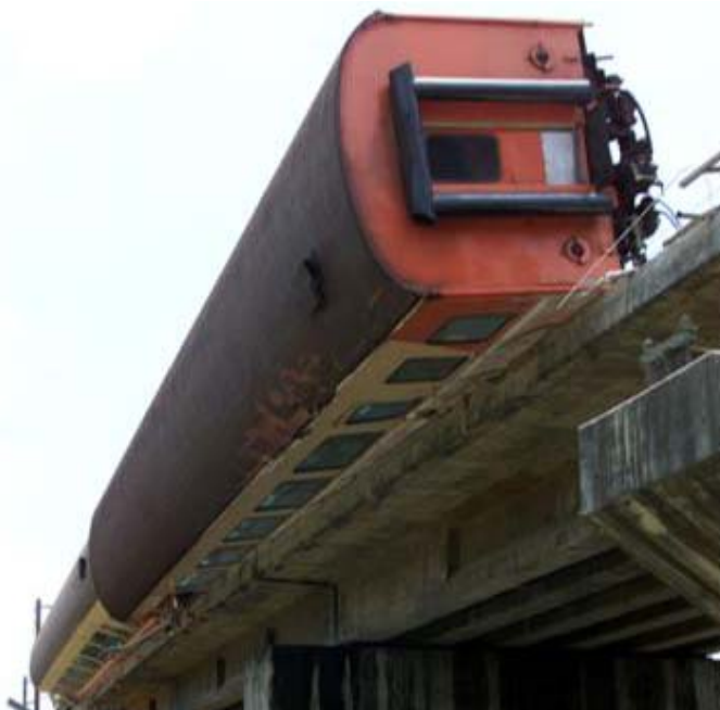
Kuva 4.1 Suistunut juna tasapainossa sillan reunalla (Anon. 2013, s. 6).
