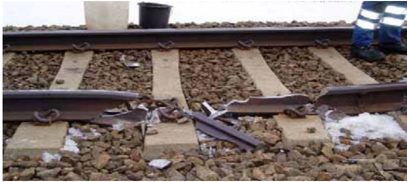
Kuva 2.8 Murtunut rataakisko (Onnettomuustutkintakeskus 2007, s. 8).
