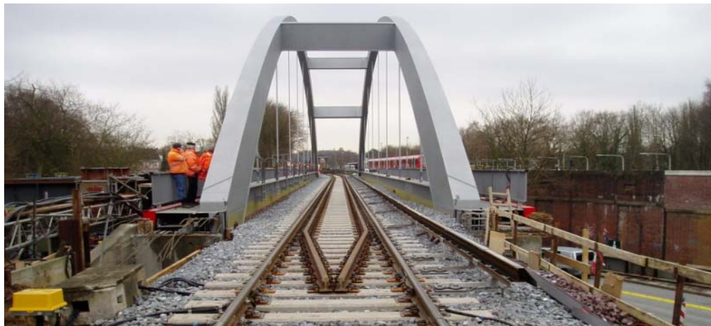
Kuva 4.2 Raiteen sisäpuolelle asennetut suojakiskot kannella, Saksa (Fettke 2013b, s. 17).
