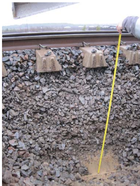
Kuva 44 Paksu ja hienoutunut tukikerros pehmeikkökohteessa P90.
